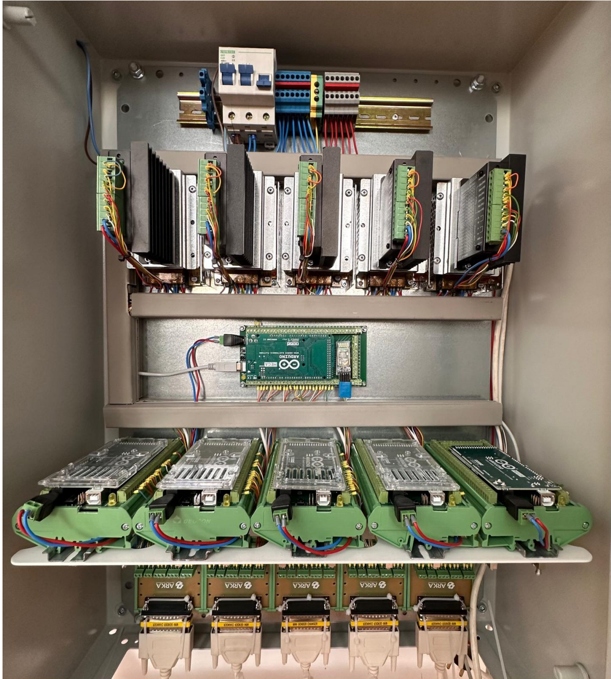
Figura. 5.17. Realizarea fizică a tabloului electric
