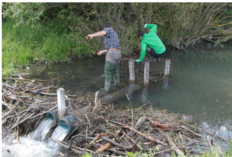
Fig. 62. Sistem de reglare a nivelului apei Water level control system
