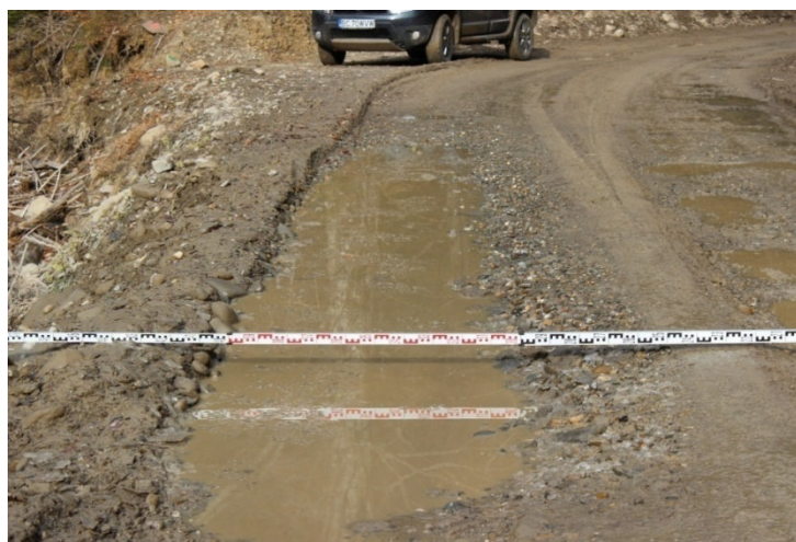
Figura 3.8. Determinări cantitative ale degradărilor identificate pe drumul forestier Ciobănuş
