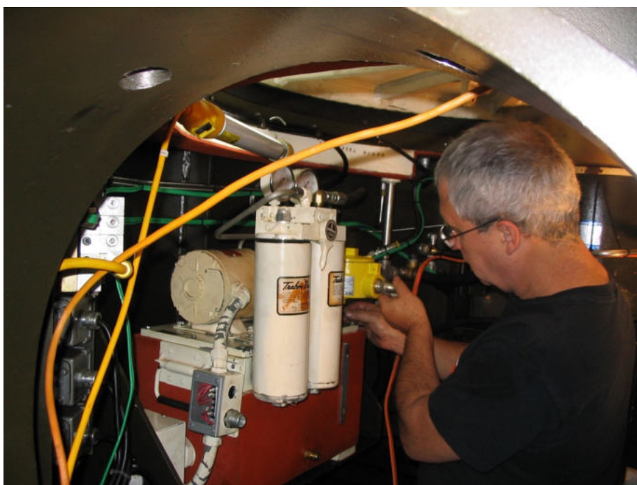
Figura 7.1: Zona tehnică a sistemului de rotire inspectată vizual de tehnician
