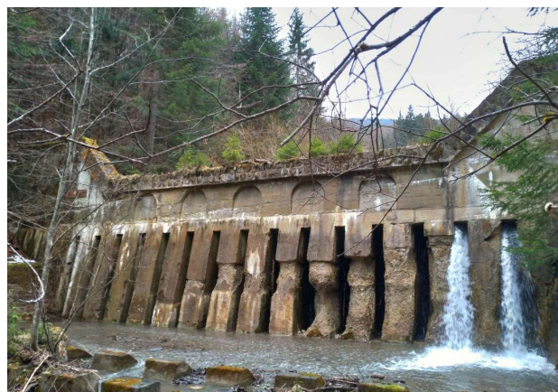
Fig. 5.33. Lucrarea 10 BF 5,0 – Valea Tigăi afectată de eroziune la nivelul lucrării propriu - zise (Foto: Mihalache, 2019)
