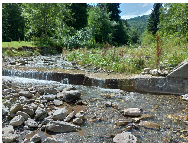
Fig. 5.28. Fisură verticală care a generat ruperea zonei deversate a lucrării 9 B 0 - Pârâul Tigăi (Mihalache, 2019)
