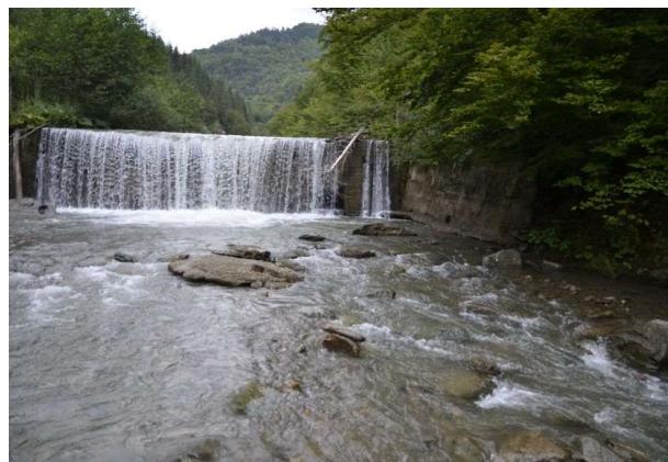
Fig. 5.34. Desprinderea totală a radierului
