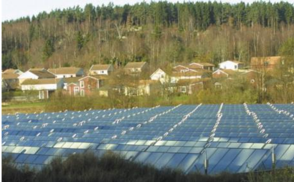
Figura 1.15. Centrala solar-termică 10.000 m 2 din Kungälv, Suedia [65]
