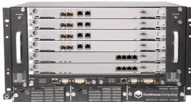
Fig. 41 Configurația experimentală – vedere frontală a platformei ATCA 40G instalate
