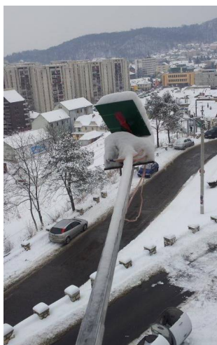
Fig. 41. Panou fotovoltaic acoperit cu zăpadă [66]
