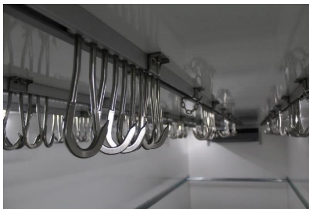
Fig. 4.29 Montajul cârligelor utilizate pentru transportul carcaselor de carne.
